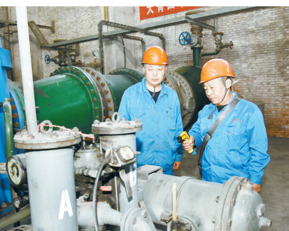
连日来,天着集团高度重视天气对装置设备工艺变化、运行变化的影响,每天时时掌控涉及变化管理的项目,及时跟进维护,确保设备安全稳定运行。图为化工人员正在现场巡检。 王爱军 摄
