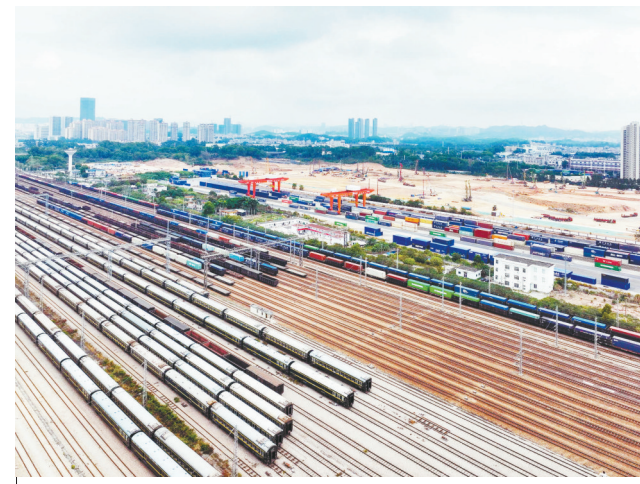
深圳平湖南综合物流枢纽项目紧邻中欧班列铁路货场(2月22日摄,无人机照片)。 由中铁四局建筑公司承建的深圳平湖南综合物流枢纽项目于2023年12月30日开工建设,目前主要进行土方和桩基作业。该项目为在传统铁路货站上建造智慧物流园,打造“公铁海”多式联运中心,是全国首批23个国家物流枢纽之一。
