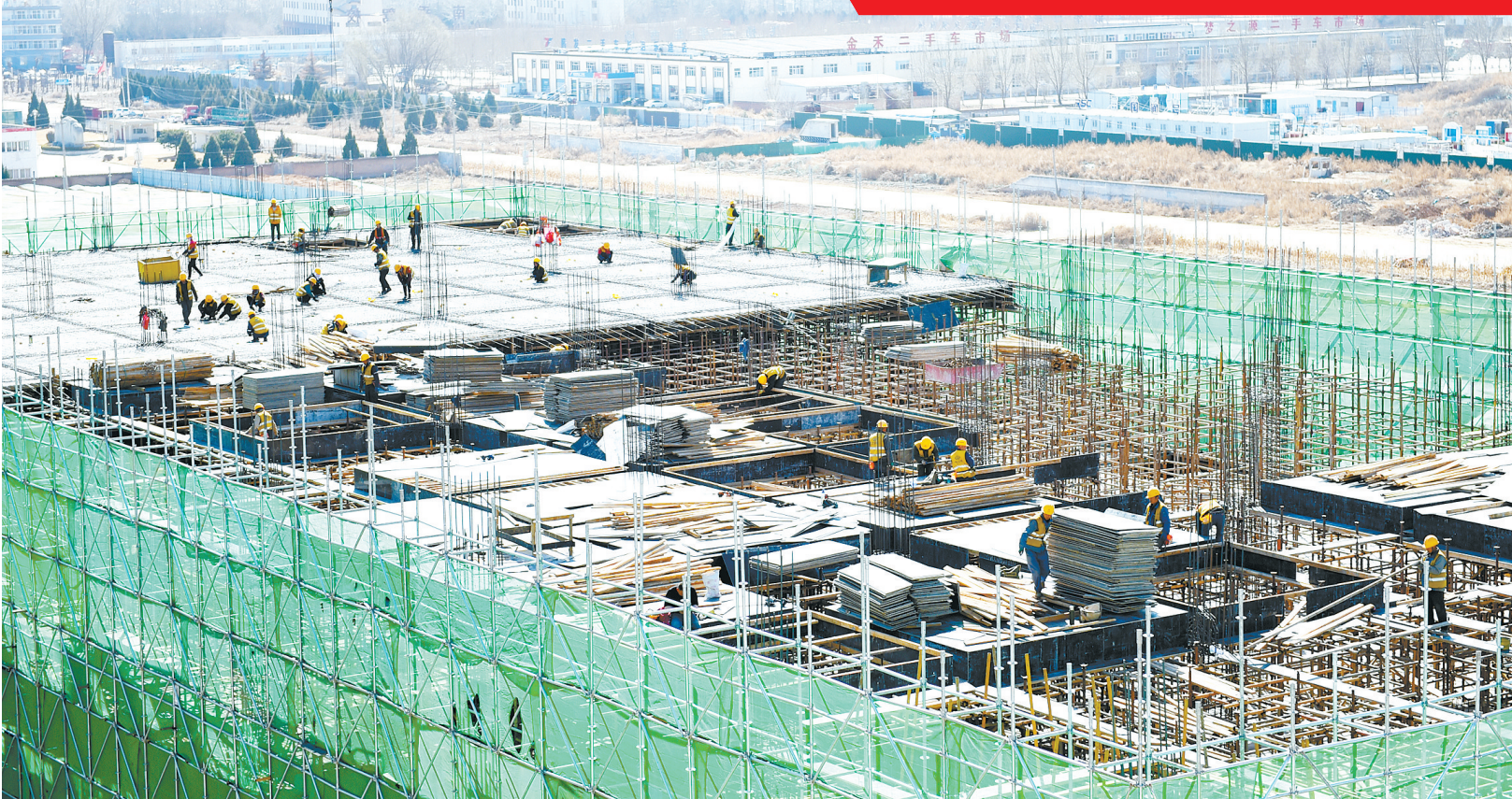
长治高新区电子信息产业制造基地加快建设,项目建成后,将为我市打造百亿级电子信息产业集群提供新的空间支撑。
