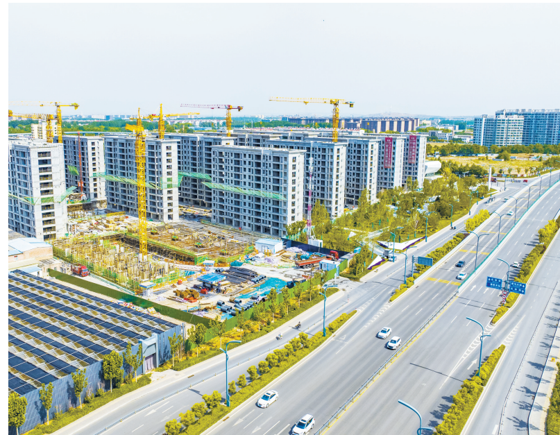
连日来，我市主城区城建重点项目开足马力抢工期，瞄准节点赶进度，按下城市扩容提质“快进键”。图为小常安置片区配套市政道路项目建设现场。
