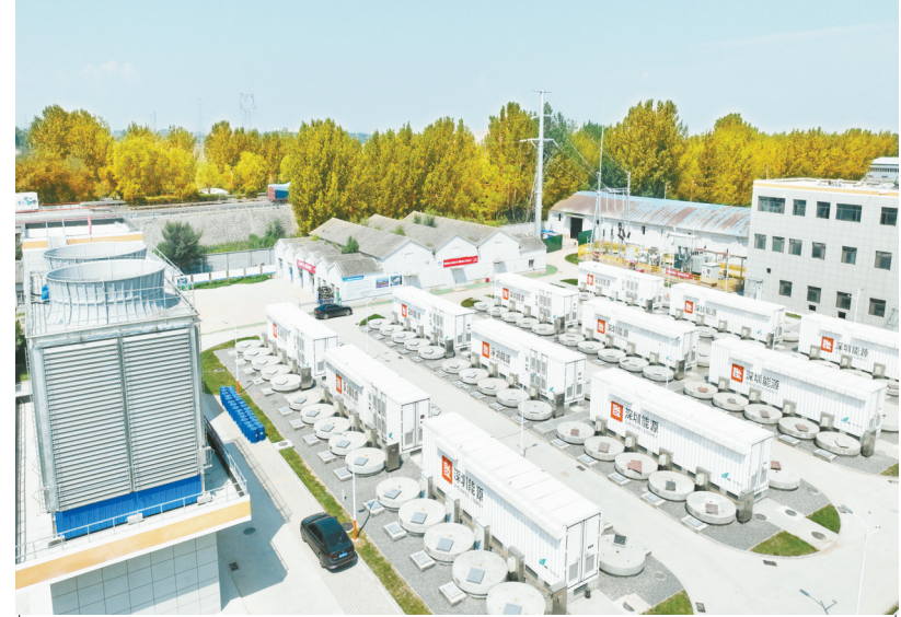
近日，我国首座电网侧飞轮储能调频电站——屯留经开区鼎轮能源30MW风电储能项目成功接入国家电网长治高头寺110KV变电站，实现并网发电。
