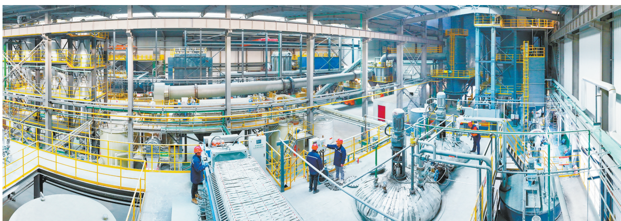
山西华星生态科技有限公司大力发展资源化循环综合利用项目
