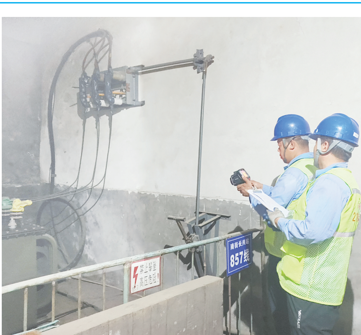
供电服务人员在校内配电室进行夜间测温工作。(国网长治供电公司提供)
