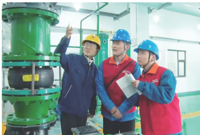
党员服务队队员为供热站仔细检查供热设备。
