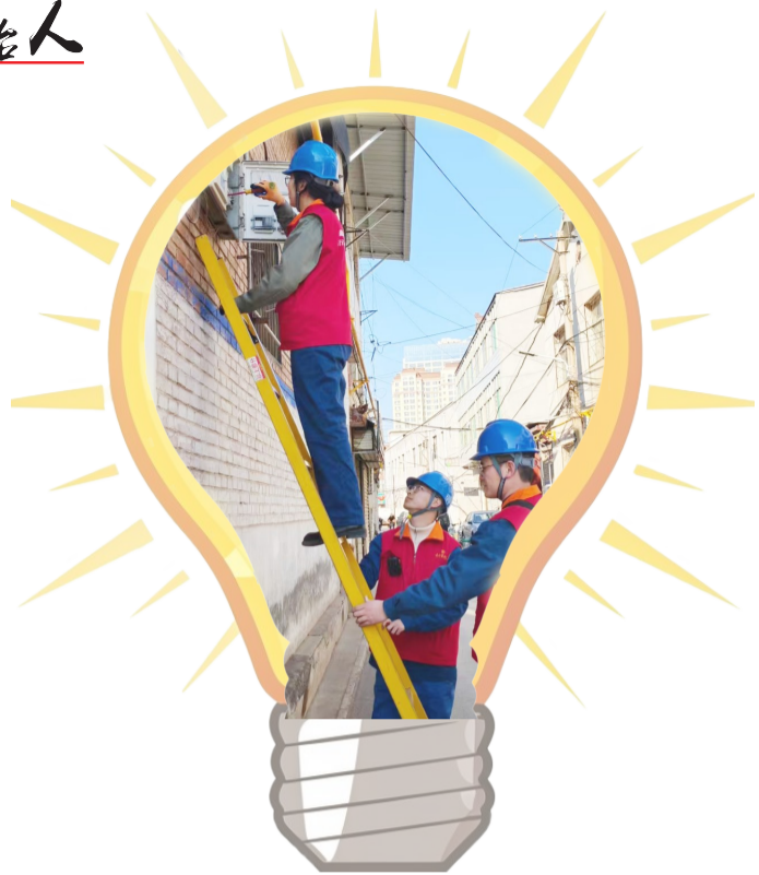
暴显明检修用电表箱。
